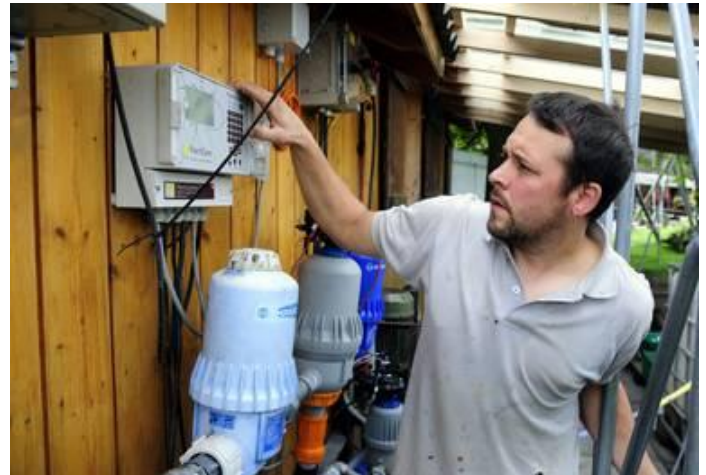
Thomas Vollenweider demonstriert, wie er das Wasser-management für die Anlage steuert. Bild: Marc Dahinden
