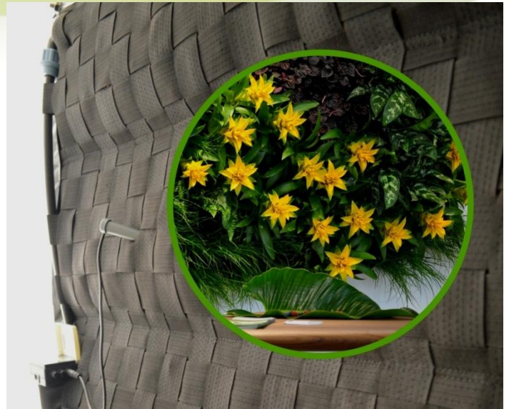
Das Bandgeflecht von gPlant ermöglicht hohe gestalterische Flexibilität. Im Bild eine kleinere Installation, bewässert mit dem Plantomat.
